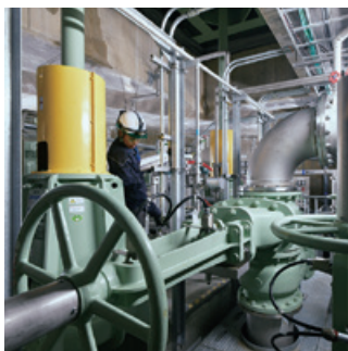
主排水ポンプ
