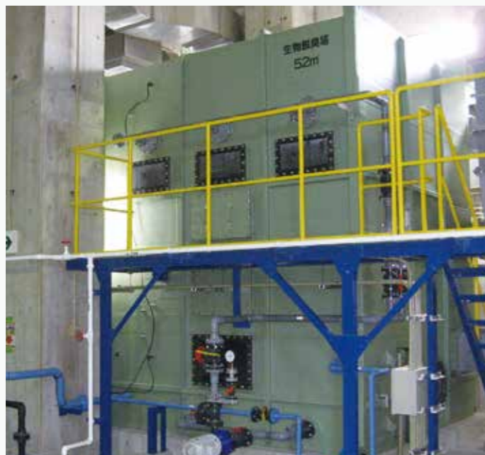
横型2塔一体型生物脱臭塔
