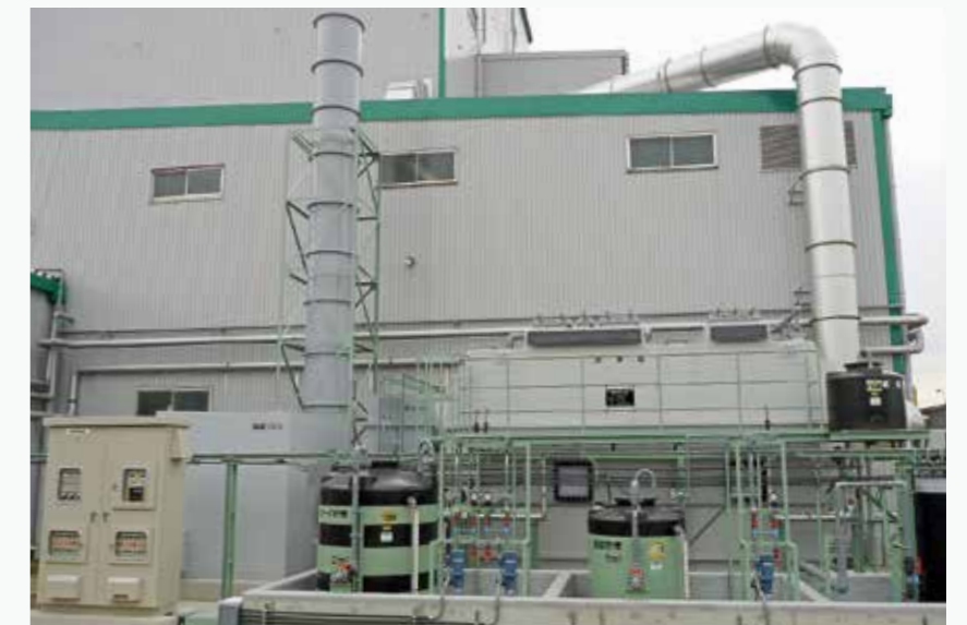
横型薬液洗浄塔
