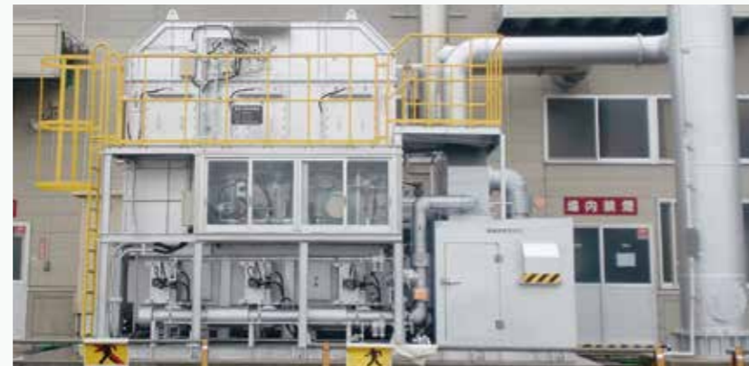
蓄熱式燃焼脱臭装置
