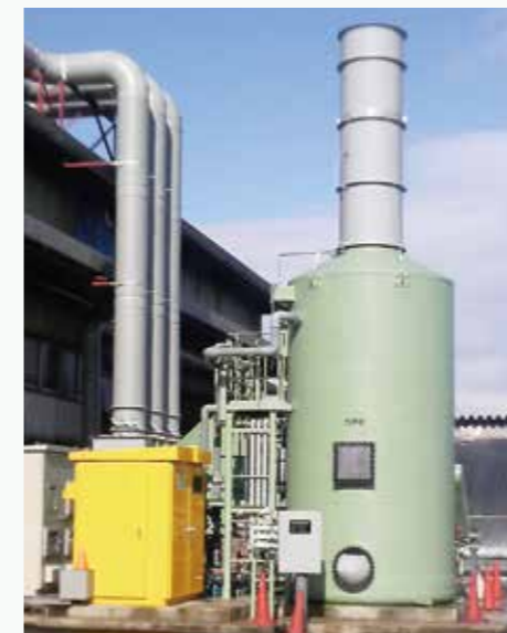
立型薬液洗浄塔
