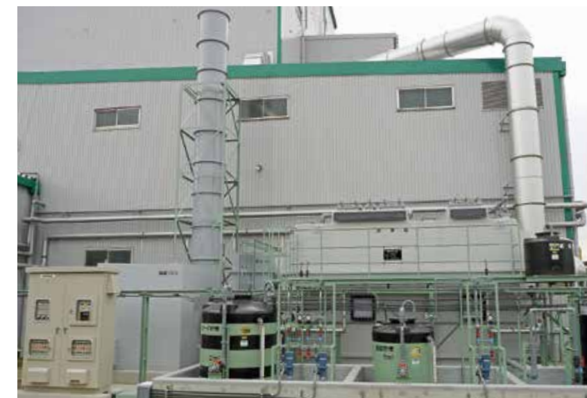
横型薬液洗浄塔
