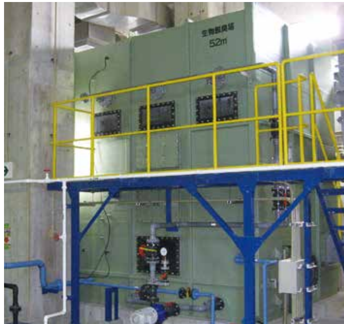
横型2塔一体型生物脱臭塔
