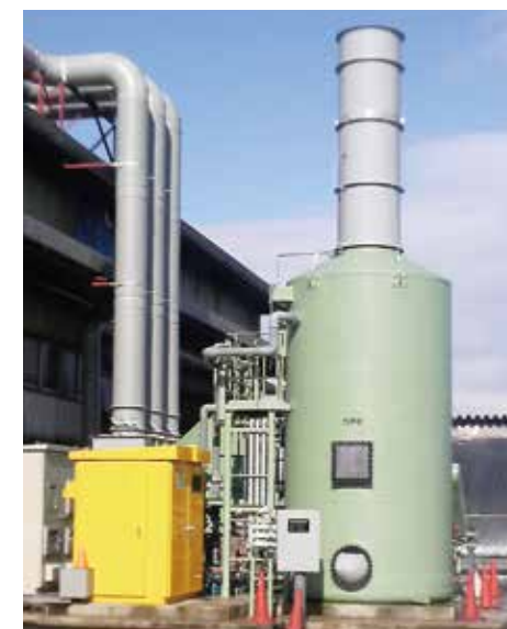
立型薬液洗浄塔
