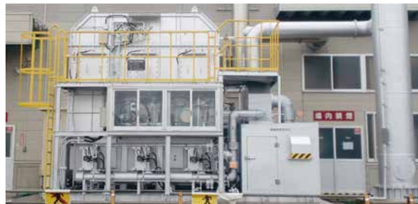
蓄熱式燃焼脱臭装置
